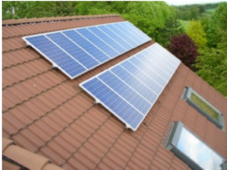
Panneau constitué de 10 cellules. Un panneau fait 5m sur 1 m.
